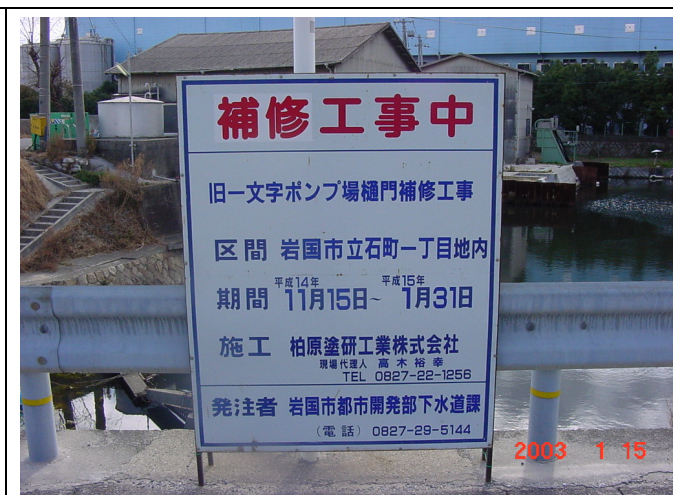
下記写真「岩国市一文字ポンプ場」
